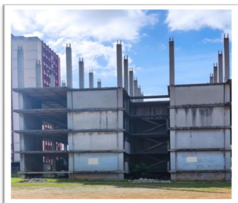
Figura 4: Suciedad en fachadas Fuente: Tomada por los autores.
