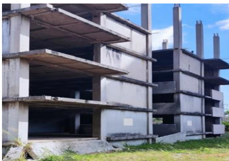
Figura 2: Desplome de losa de balcón debido a falla de cono de cables de postesado Fuente: Tomada por los autores.
