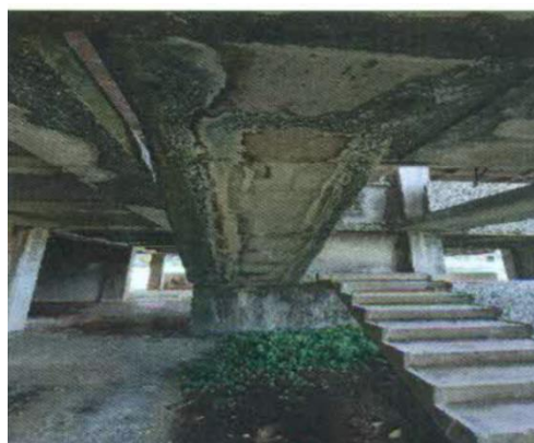
Figura 5: Organismos vegetales en el sótano de la edificación. Fuente: Tomada por los autores.
