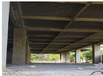
Figura 3: Entrepiso 2 con eflorescencias y manchas de humedad. Buena coloración del hormigón en columnas. Fuente: Tomada por los autores.
